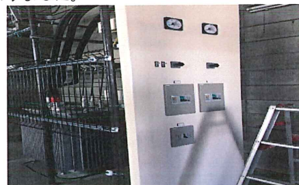
※2017年1月 電気室内トランス増設工事実績
